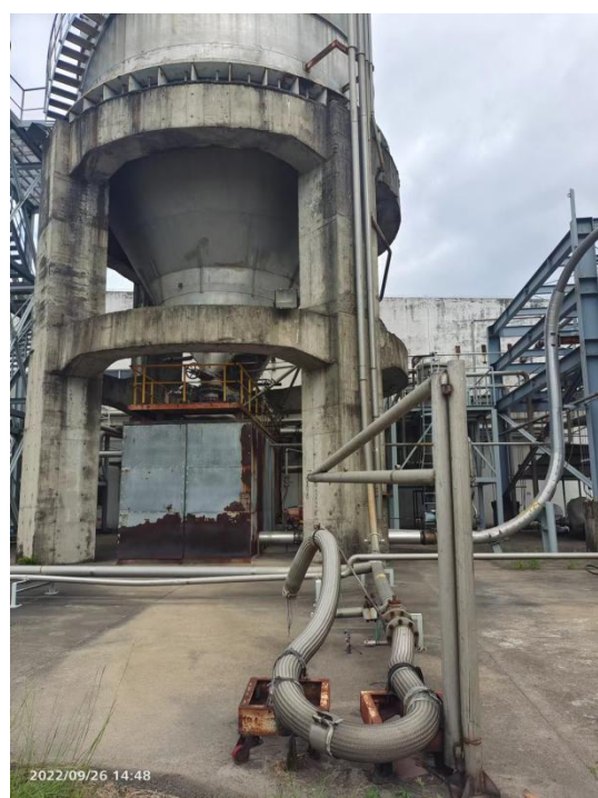
对苯二甲酸储罐
