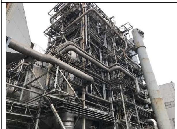
热电联产锅炉设备
