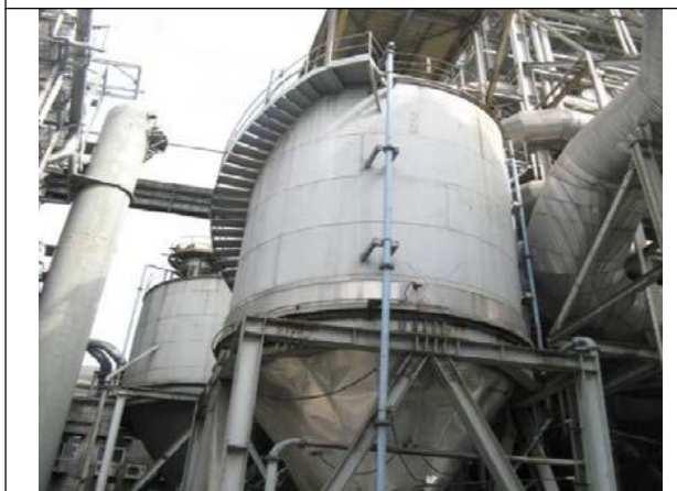
热电联产锅炉脱硫设备
