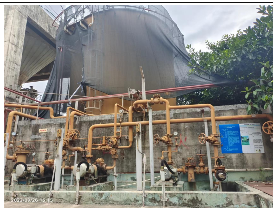
柴油储罐装卸口
