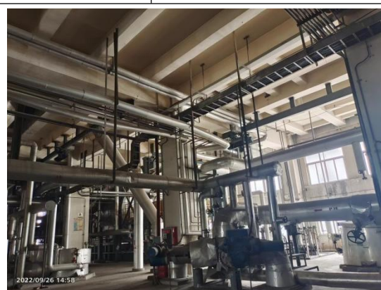
车间输送管道（2）
