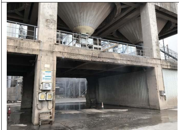
灰库及喷淋除尘设施
