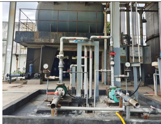
酸碱储罐装卸口
