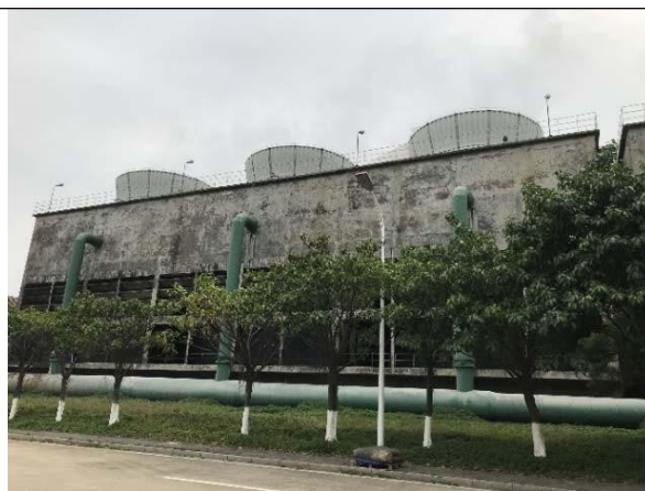
汽电部冷却塔
