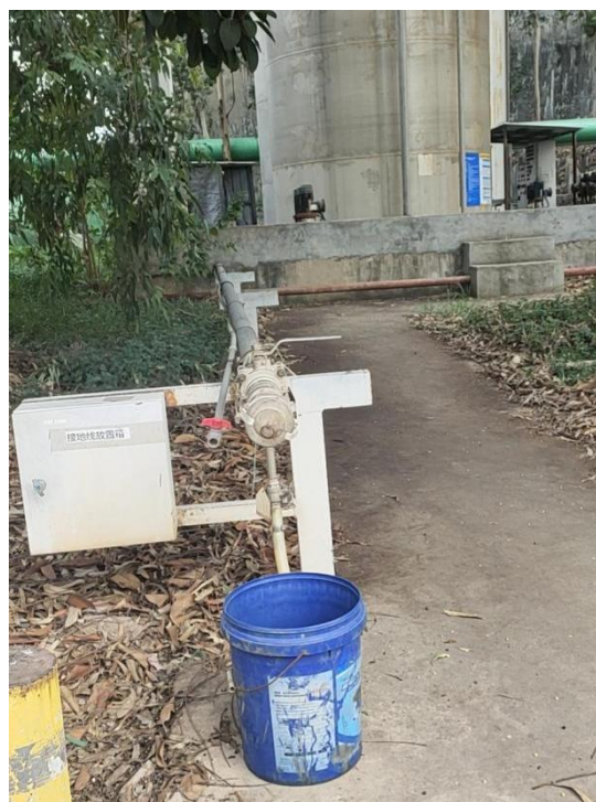
氨储罐装卸口
