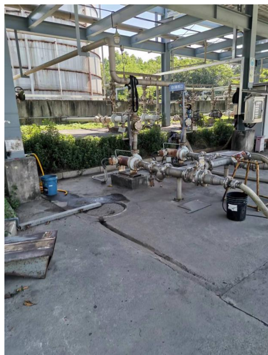
EG 罐区装卸口
