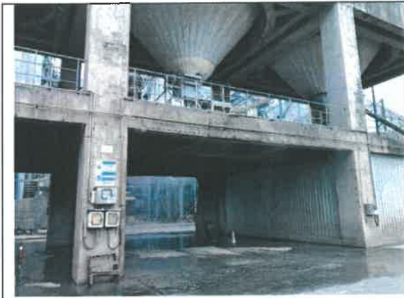
灰库及喷淋除尘设施
