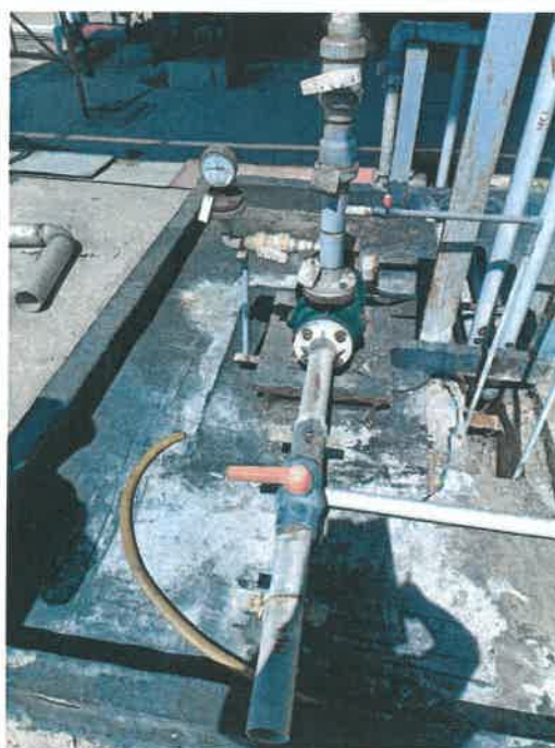
酸碱储罐装卸口
