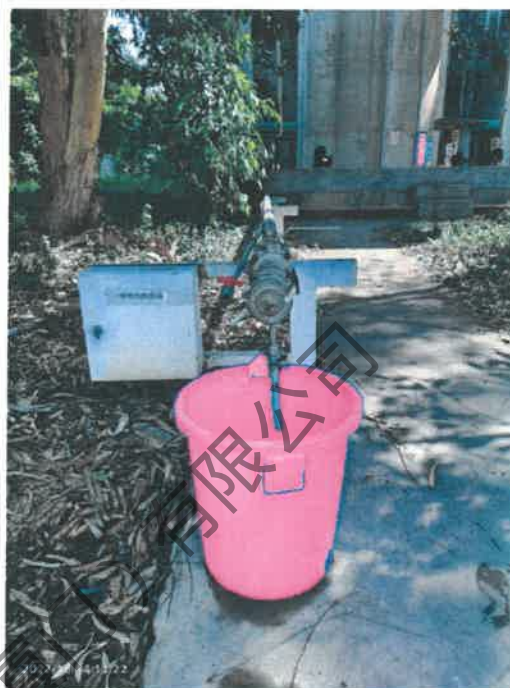
氨储罐装卸口
