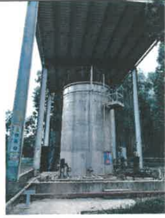
氨水罐及围堰
