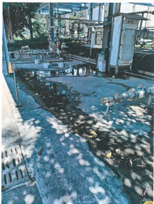
EG 罐区装卸口
