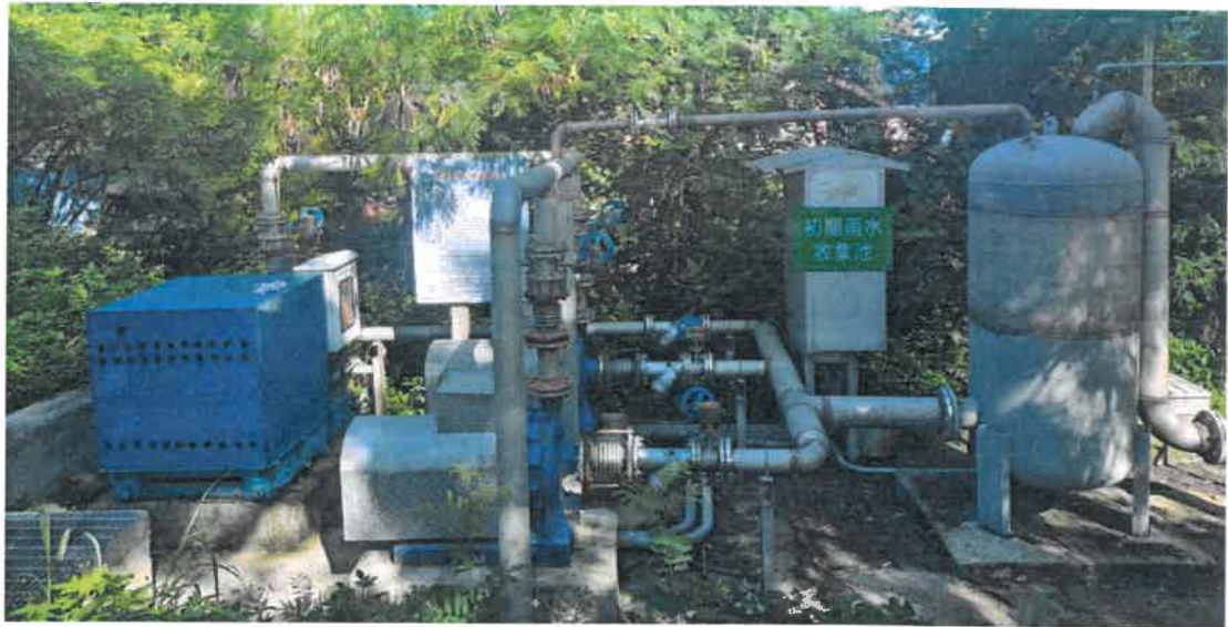
初期雨水收集系统
